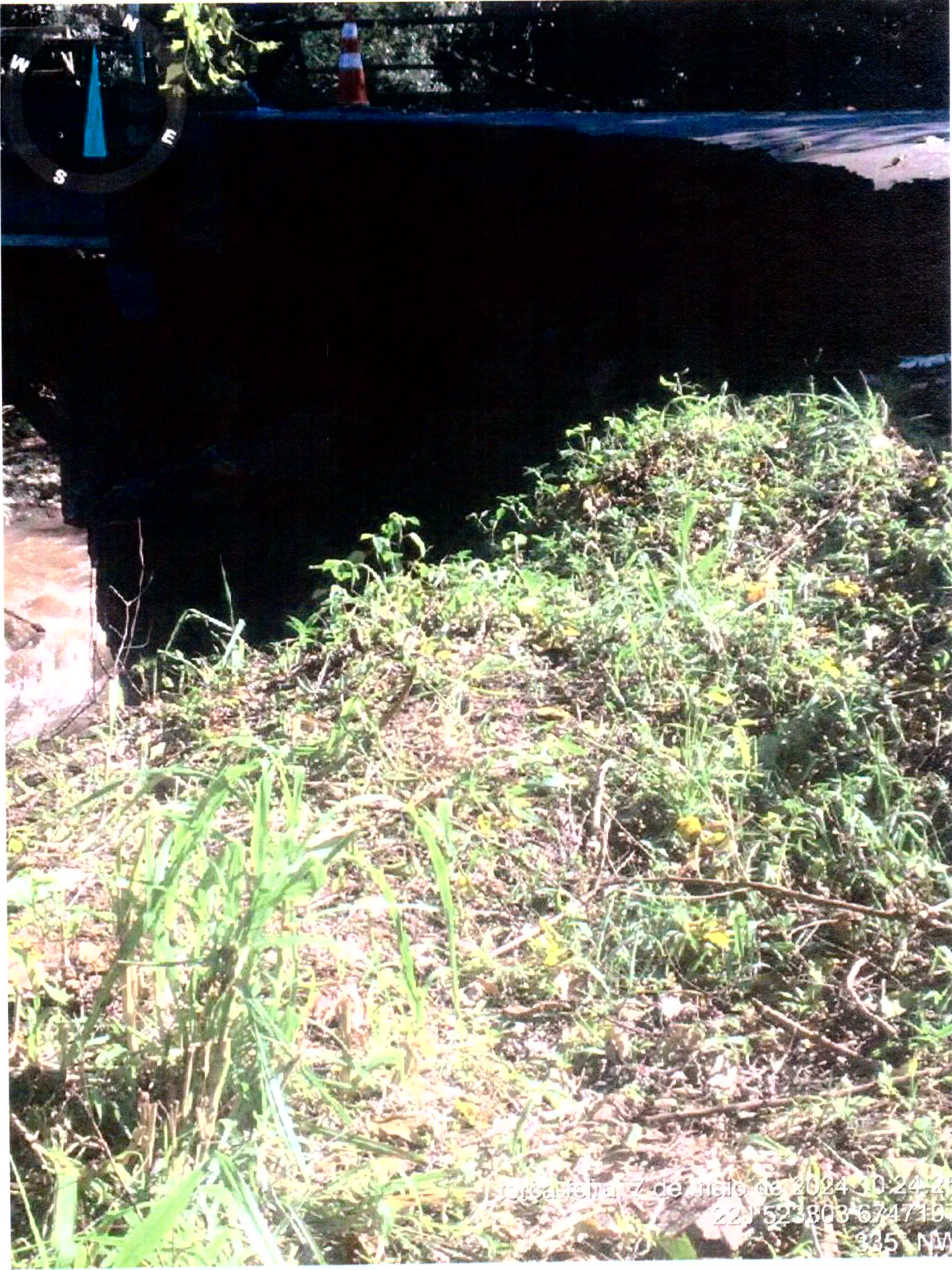
Legenda: FOTOS DA EROSÃO LADO DIREITO DA PONTE.
