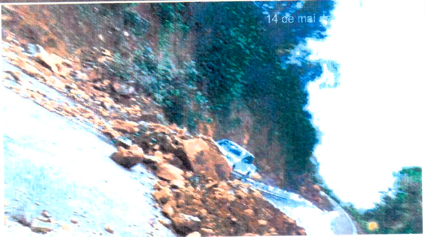
Legenda: LOCAL DE DESLIZAMENTOS DE TERRA E PEDRA NA ROTA PANORÂMICA.
